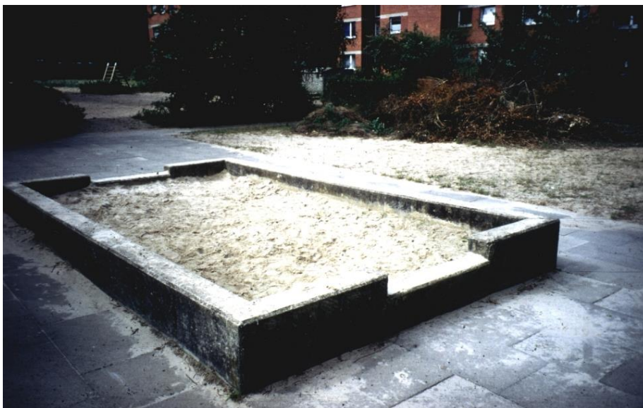
Bild 33: Spielplatz W.- Leuschner-Straße nördlicher Teil vor der Sanierung
